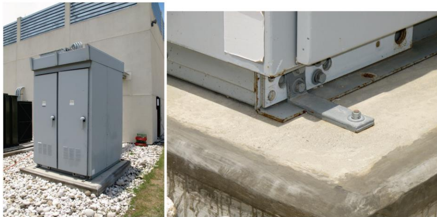
איור 6.4.7.3-4 – ארון חשמל חיצוני למתח נמוך המספק כוח חיוני למתקן חשוב. שימו לב כי הציוד מעוגן סיסמית באמצעות חיבורים קשיחים ארוכים המוברגים למסגרת הציוד ולפלטת הבסיס. התמונה צולמה לאחר רעידת אדמה.
