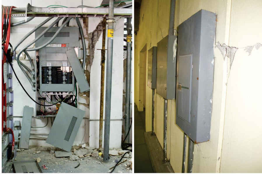
איור 6.4.7.3-8 – דוגמה לציוד קשיח. התמונות צולמו בשני מתקנים שונים שניזוקו לאחר רעידת אדמה. לוחות הפיקוד המעוגנים לקיר לא נפגעו במהלך הרעידה והמשיכו לתפקד כראוי, על אף שהקירות אליהם הם מחוברים ניזוקו מאוד.
