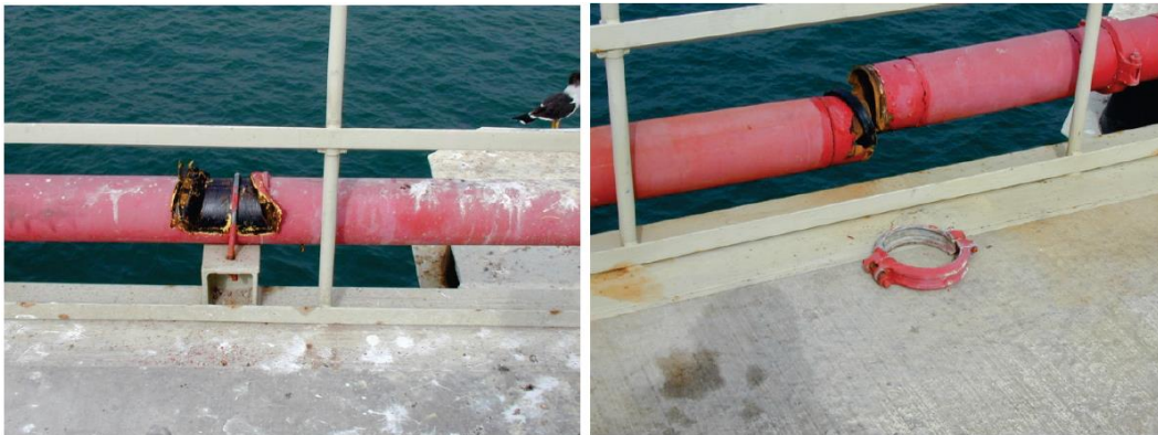
איור 6.4.4.1-6 – נזק לצנרת כיבוי אש תעשייתית. מצד ימין – כשל במחבר להצמדת צינורות ומעיכת הצנרת; מצד שמאל – החלקה בכיוון האורכי במחבר U הנותר שלם, אך המחברים האחרים נשברו ונפלו.
