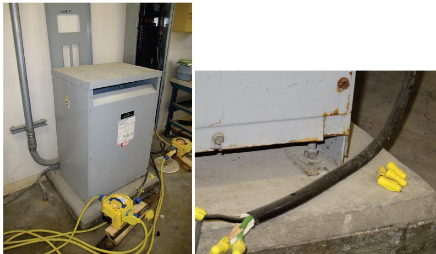
איור 2-6.4.7.3 – שנאי מפצל יבש טיפוס. שימו לב לעיגוני הבסיס שיוצרו כחלק מהמתקן. התמונה צולמה לאחר רעידת אדמה.
