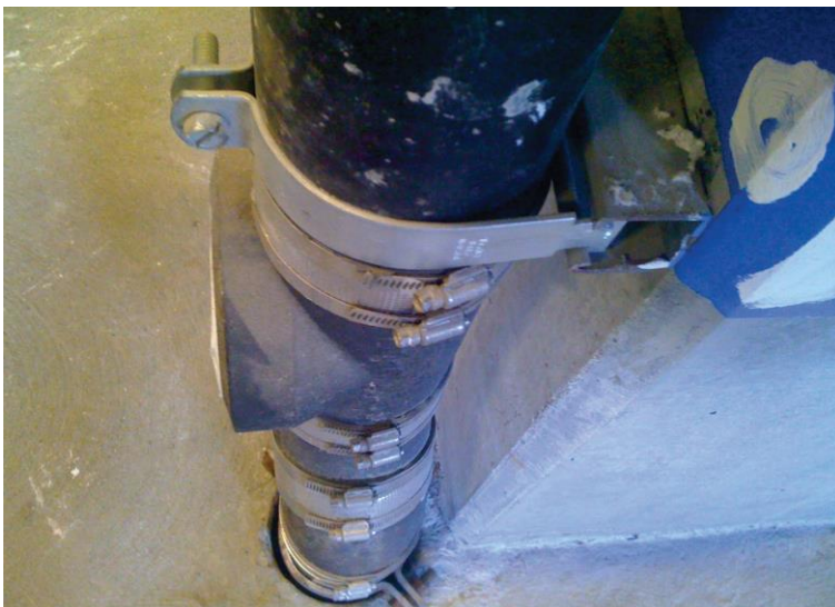
איור 5-6.4.5.2 – דוגמה להתקנה לקיחה של תמיכה בצנרת סניטרית. המרחק של החבק מקצה הקורה התומכת איננו תקין והוא עלול להחליק החוצה.
