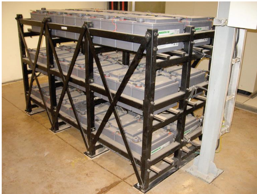
איור 6.4.7.4-4 – מדפי סוללות שתפקדו כראוי במהלך רעידת אדמה.
