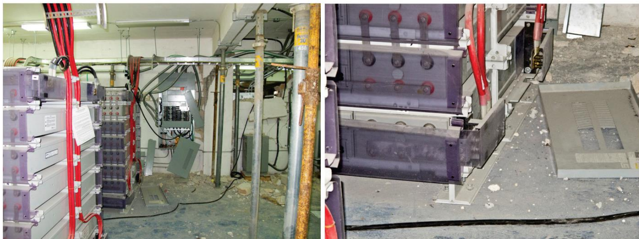
איור 6-4.7.3-6 – חדר סוללות במתקן רשת סלולרית לאחר רעידת אדמה. המבנה בן שלוש הקומות ניזוק מאוד ברעידה ועבר הריסה ובנייה מחדש. שימו לב לטיגון הקשיח של הסוללות המאסיביות שלא נפגעו תפקודית במהלך הרעידה, על אף שהמבנה ספג הזזות גדולות שגרמו לגזירת העמודים התומכים.
