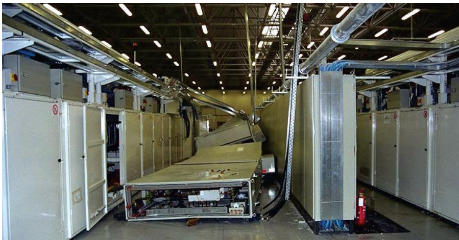
איור 2-6.4.7.1 - התהפכות ארונות חשמל לא מעוגנים במפעל לייצור נייר.
