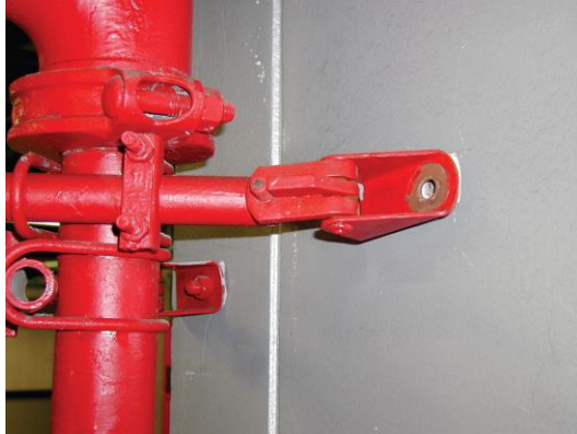
איור 2-6.4.4.1 – כשל בעיגון צנרת כיבוי אש עקב חיבור לקוי למסגרת המבנית.
