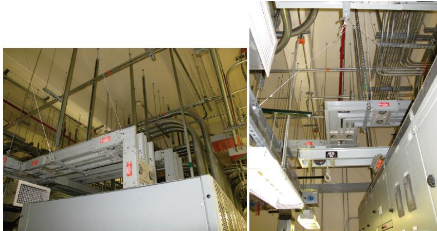
איור 6.4.7.3-3 – מערכת מתח גבוה המעבירה כוח מגנרטור ארון חשמל למתקן. שימו לב לעיגונים בניצב למתלים האנכיים. המערכת תפקדה כראוי בזמן רעידת אדמה.
