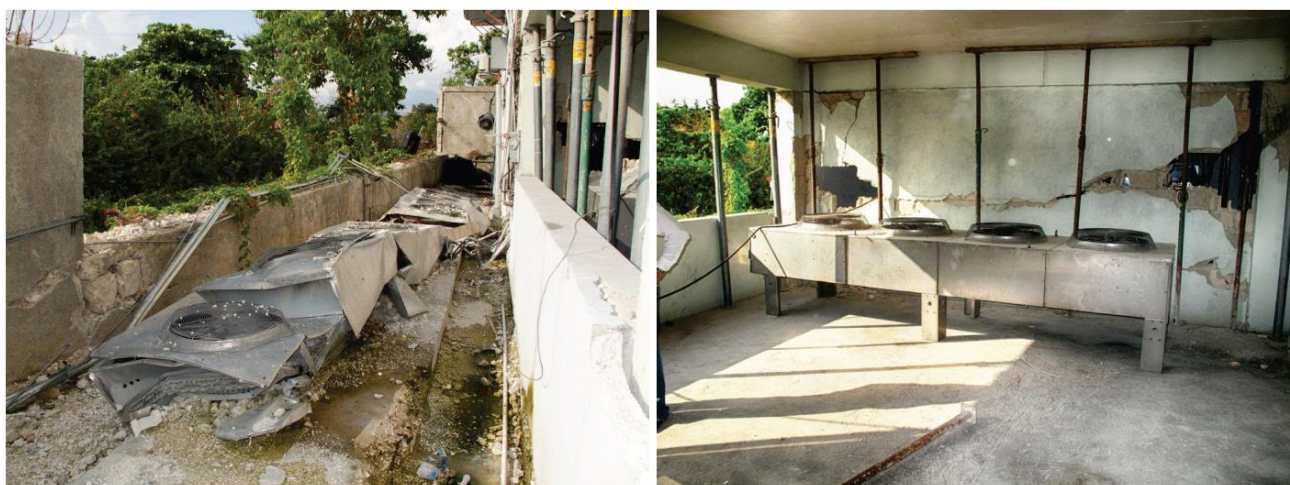
איור 6.4.7.3-7 – יחידות מכניות דוחות חום אשר מספקות קירור לשרתים במרכז רשת סלולרית (בתמונה משמאל). התמוטטות קיר במהלך הרעידה הובילה למעיכת היחידות ולהשבתת תפקודן. יחידות חלופיות זמניות הותקנו בכדי לאפשר למרכז הרשת לתפקד לאחר הרעידה (בתמונה מימין). דוגמה זו ממחישה את חשיבות עיגון המערכות הקריטיות לתפקוד השוטף ומיקומן באזורים לא סמוכים לרכיבים מבניים או לא-מבניים שעלולים ליפול עליהם.
