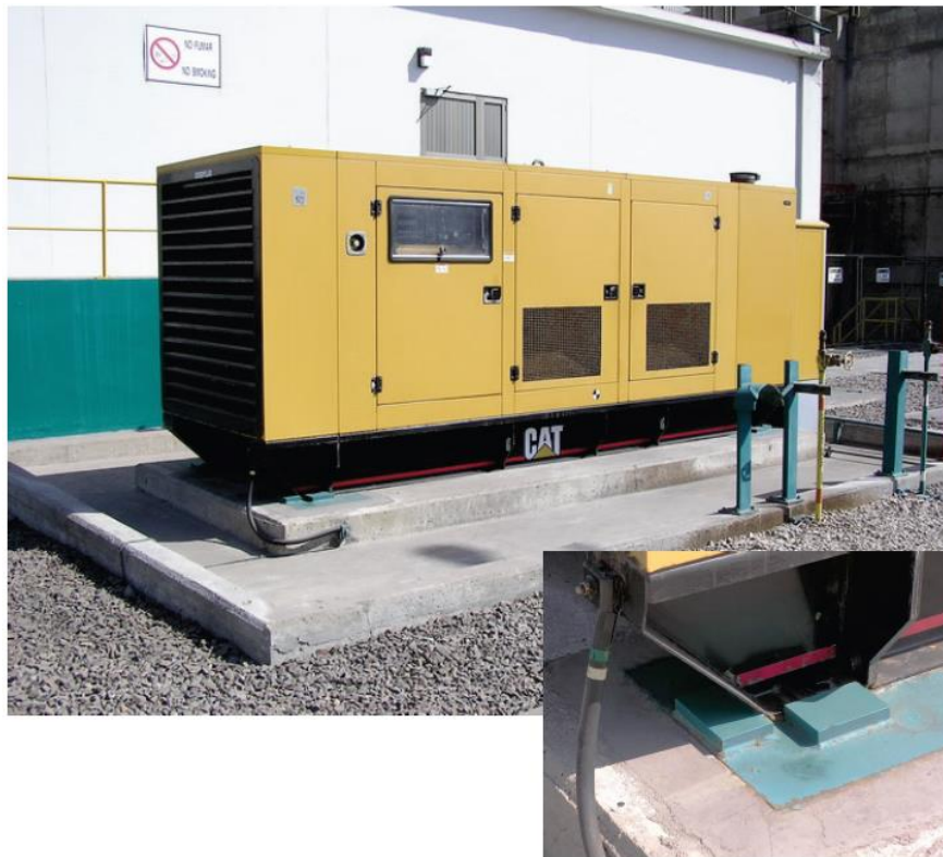
איור 2-6.4.7.2 – גנרטור חירום עם תושבת החלקה ממוקם על משטח פלטת בטון. הותקנו "Shear Lugs" לאחר התרחשות רעידת אדמה.
