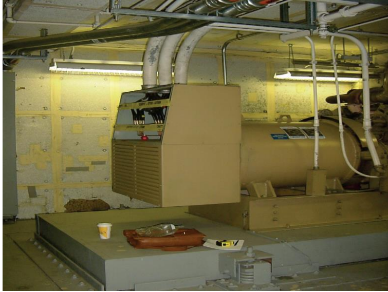
איור 1-6.4.7.2 – גנרטור חירום המעוגן לבסיס בטון אינרטי. הבסיס האינרטי מחובר לקפיצים מבודדים ומעוגן לרצפה באמצעות זוויתני פלדה מכל הצדדים.
