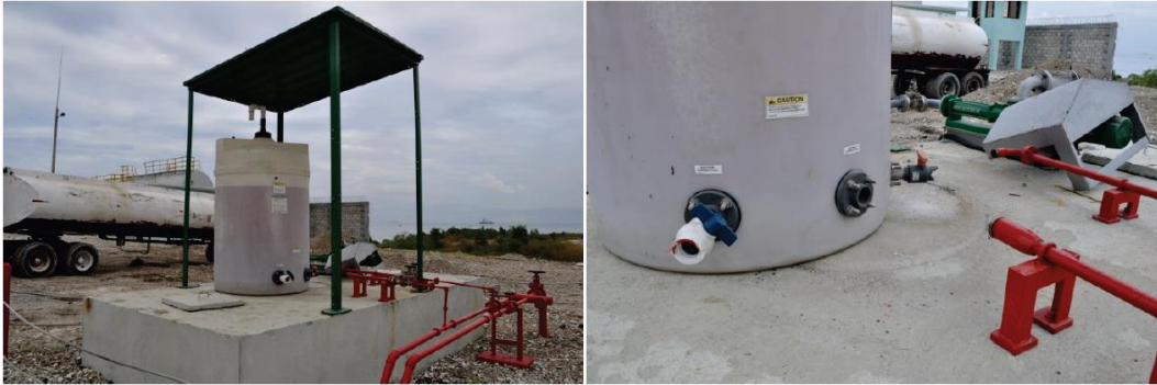
איור 6.4.4.1-5 – מיכל אחסון לא מעוגן על משטח בטון החליק וגרם לשבירה ולהשבתה של צנרת כיבוי האש.
